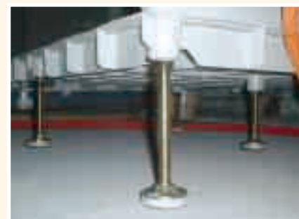
カルムーンダンパー設置部分
